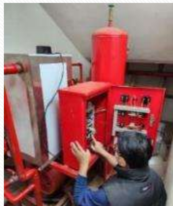
消防泵浦系統
