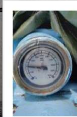
監控大排閘門系統
