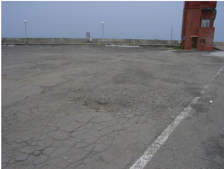
靠近北堤基地台處路面龜裂
