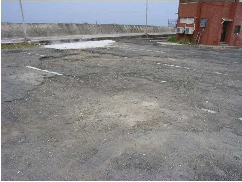
北堤基地台旁路面破損
