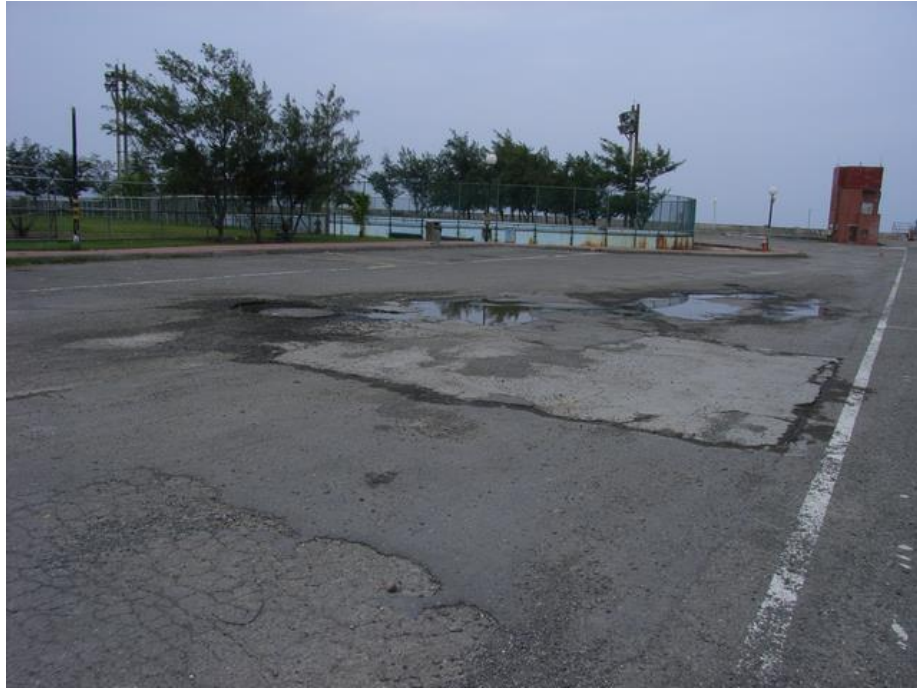
壘球場旁道路龜裂容易積水
