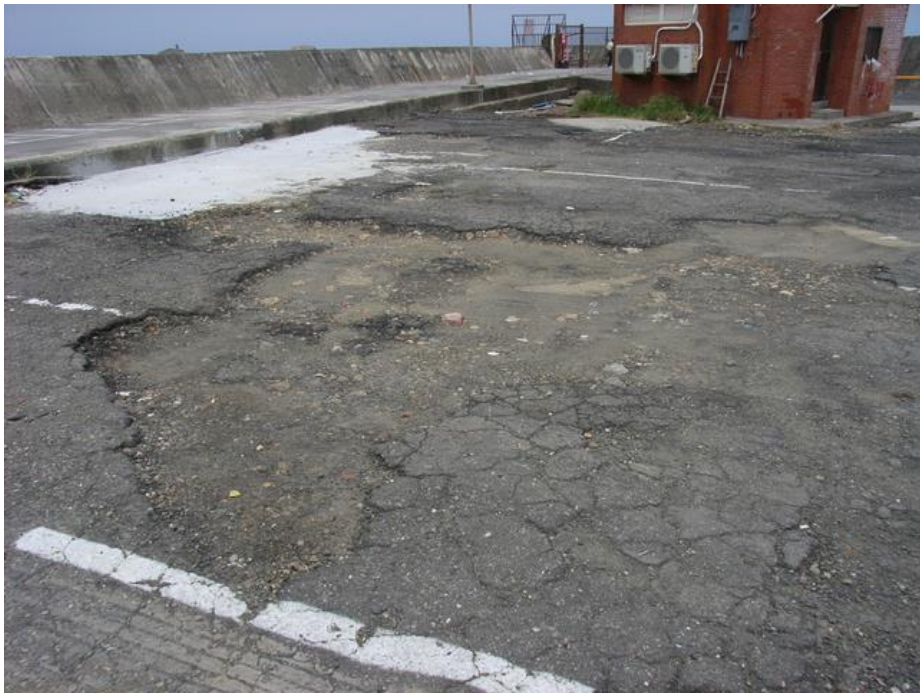
北堤基地台旁路面破損
