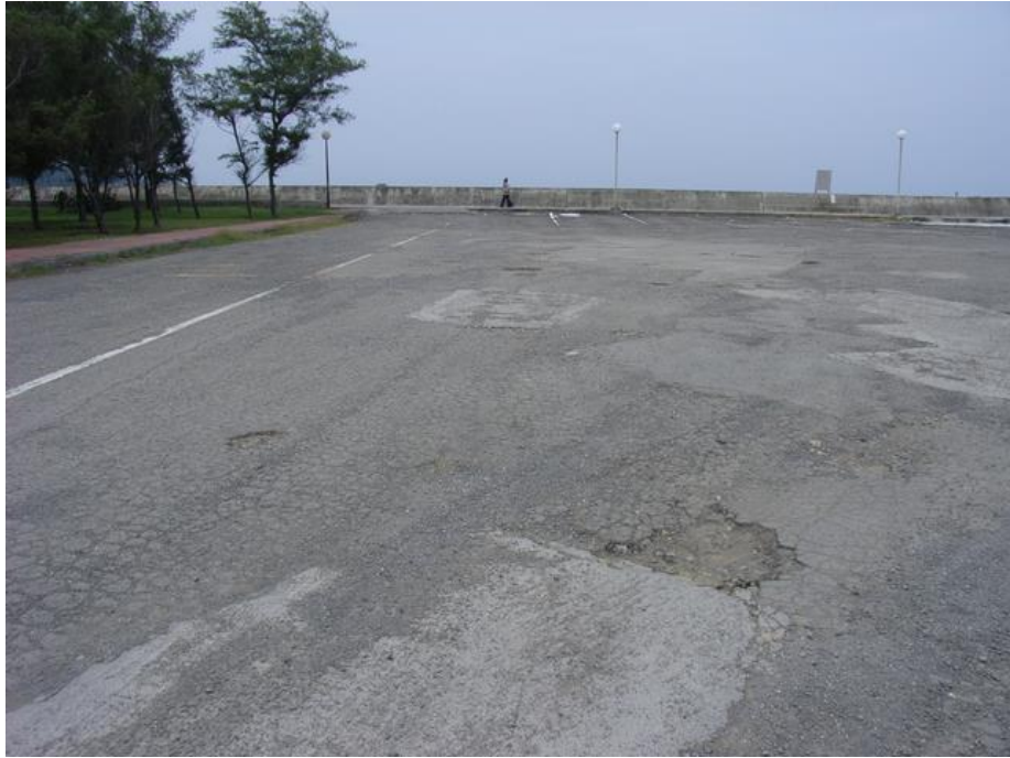
溜冰場旁路面破損
