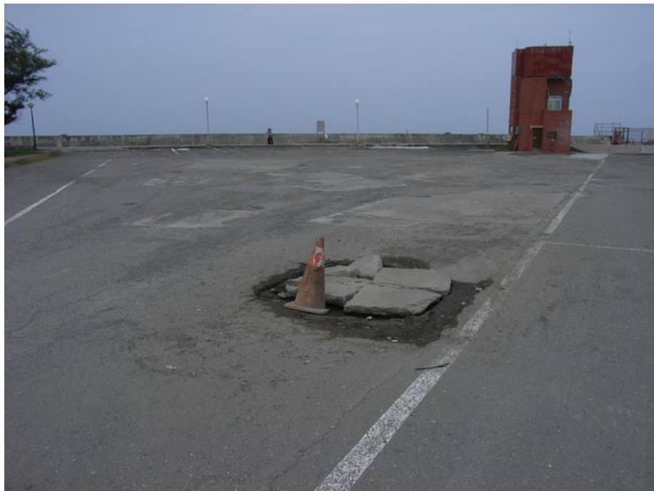
溜冰場旁道路破洞，以石塊及三角錐填補警示
